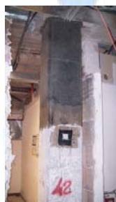
Esecuzione di indagini sperimentali a seguito dell'intervento di rinforzo. Pull-of per verificarne la corretta applicazione
